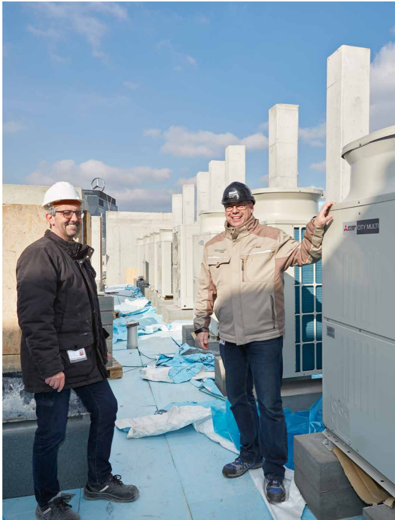
Noch ohne Sichtschutz: 13 Außengeräte der Hybrid-VRF-Anlage auf dem Dach des Hotels Indigo. Die Projektpartner Jens Neder und Mario Lützins sichten die Lage auf der Baustelle, auf der die Installationsarbeiten im Rohbau in vollem Gange sind. Besondere Herausforderung im Projekt: Es galt die Vorschriften aus der Baubeschreibung und der DIN EN 378 unter Verwendung möglichst weniger Außengeräte einzuhalten.
