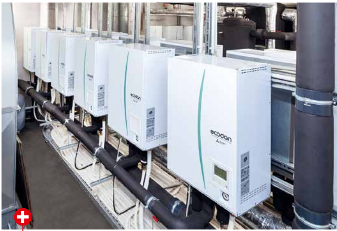
Die Inneneinheiten befinden sich in der ehemaligen Lüftungszentrale von Karstadt.
