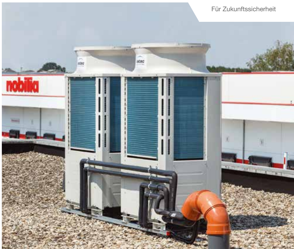
Das Flachdach des Bürogebäudes eignet sich optimal für den Aufbau der Außengeräte. Von hier aus versorgen die City Multi VRF-Einheiten die beiden Stockwerke mit genügend Kälte- und Heizleistung.
